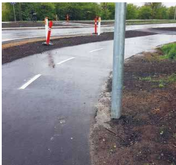
Faste genstande bør stå mindst 30 centimeter fra stiens kant, så en let trafikant ikke rammer genstanden med styr eller pedal. Med en revision på trin 3 kunne lysmasterne være placeret korrekt uden ekstra omkostninger. Nu er det (for) dyrt at flytte alle lysmasterne.
